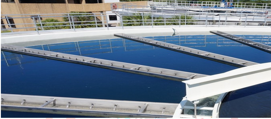
Şekil 2: Endüstriyel su arıtma sistemi [15]
