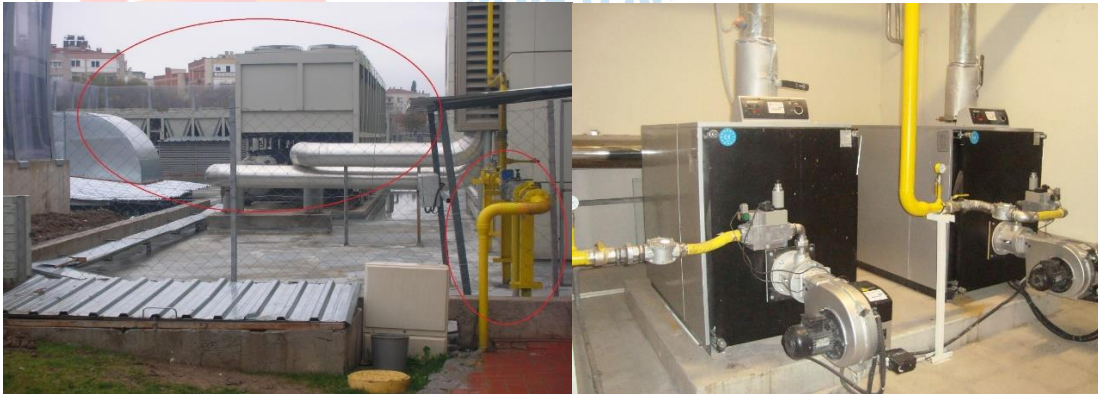
Fotoğraf-1: İzmir Büyük Şehir Belediyesi, Aşık Veysel Rekreasyon Alanı buz pisti tesisine ait endüstriyel tip soğutma grupları ve sıcak su temini için kullanılan doğalgaz kazanları.
