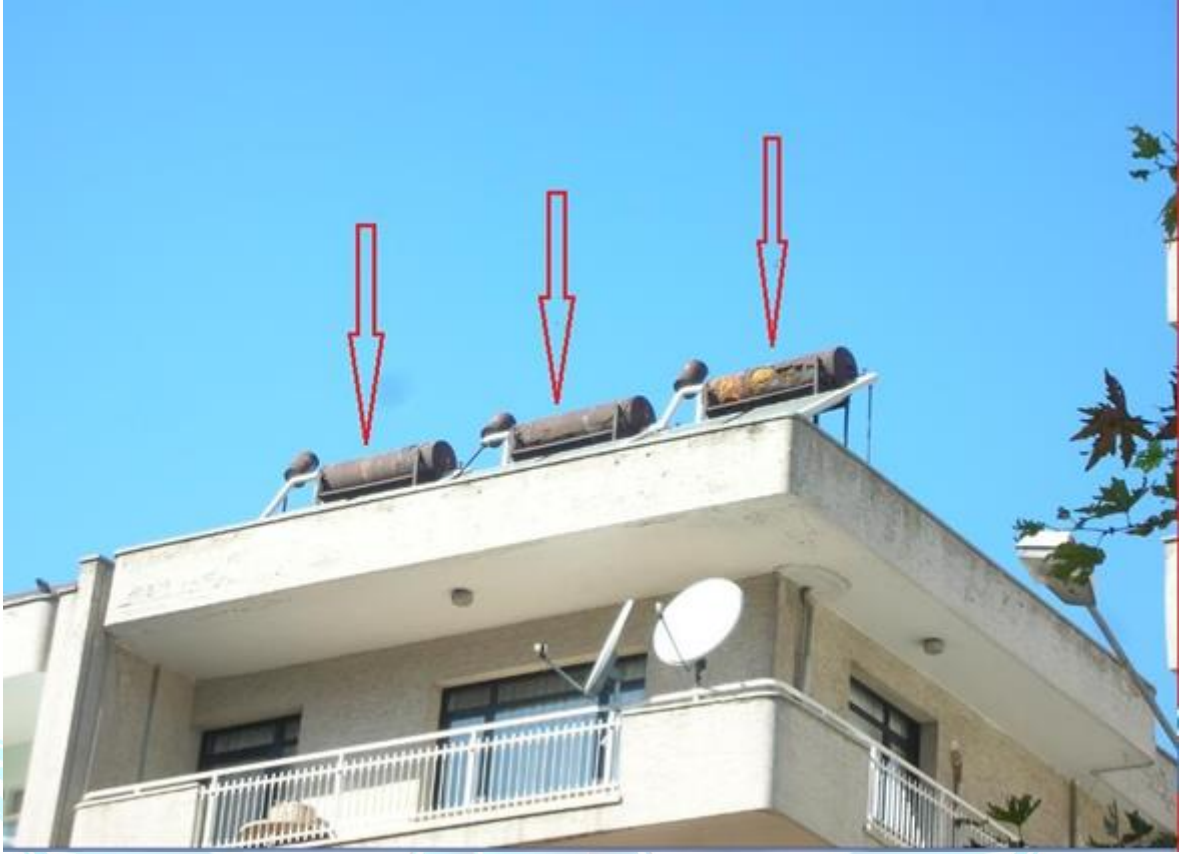
Fotoğraf-2.4: Dış etkenlerden dolayı tahribata uğramış güneş kolektörü.
