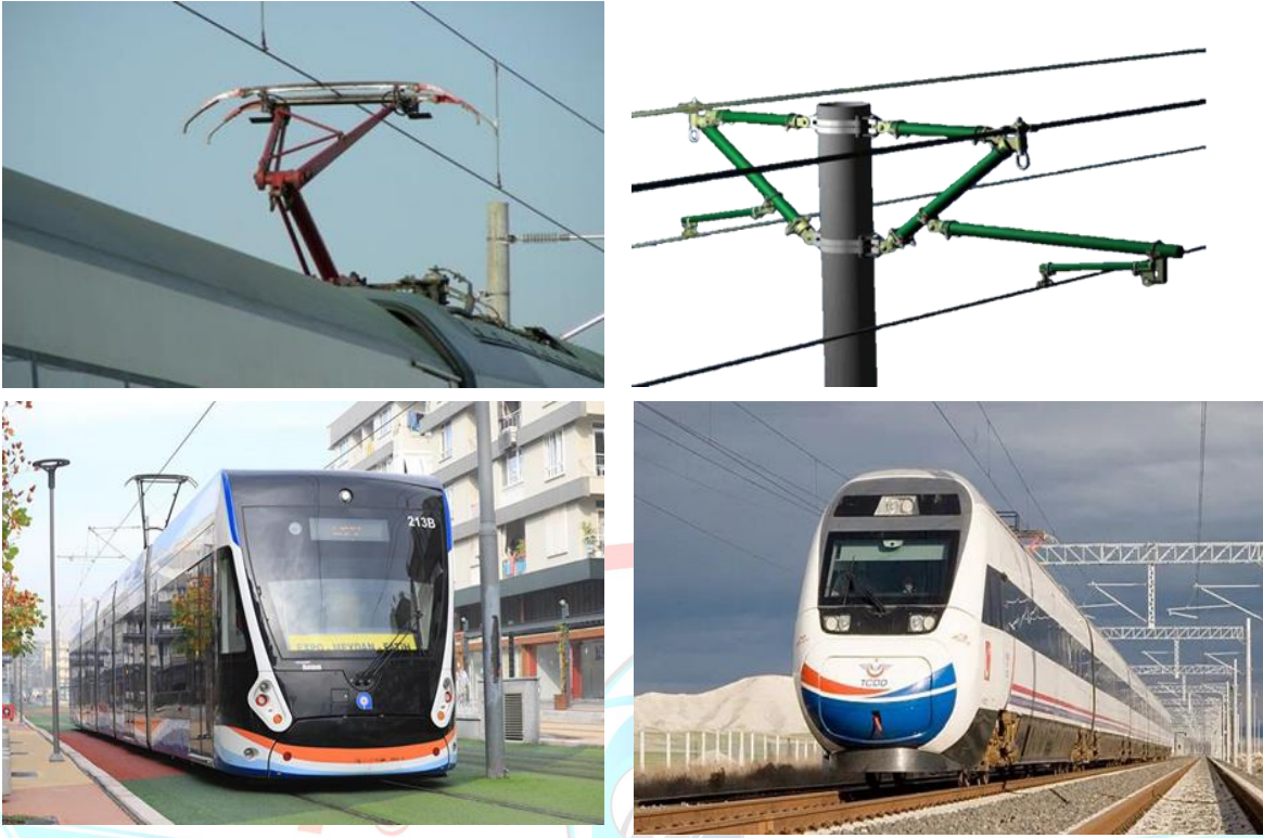
Şekil 10. Katener: Trafo merkezlerinden aldığı enerjiyi hat boyunca araca ileten sistem.
