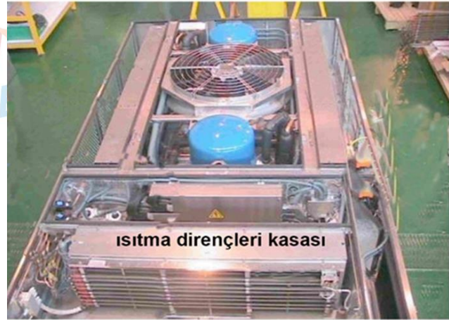
Şekil 9. Mevcut tramvaylarda kullanılan iklimlendirme dış ünitesinin üstten görünümü.
