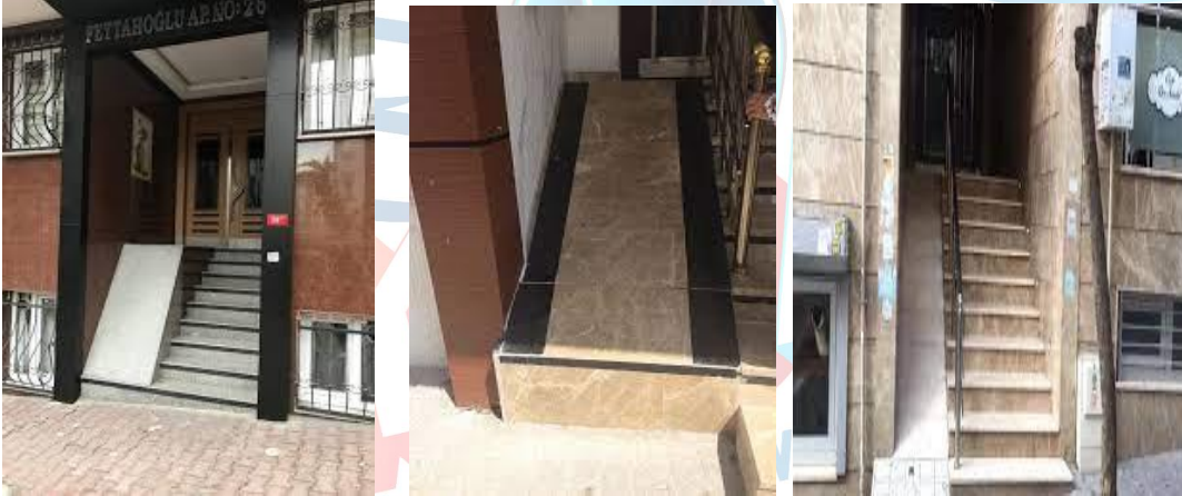
Resim 1. Standartlardan uzak yapılmış engelli rampaları
