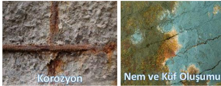
Resim 4. Beton ve Demirde Meydana Gelen Yapısal Değişimler
