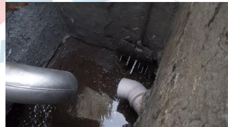
Şekil 5. Tekstil atık sularının kanalizasyona deşarj edildiği yer
